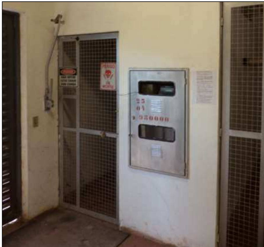
Figura 16. Lado externo do cubículo de medição dentro da subestação do HUGD.
