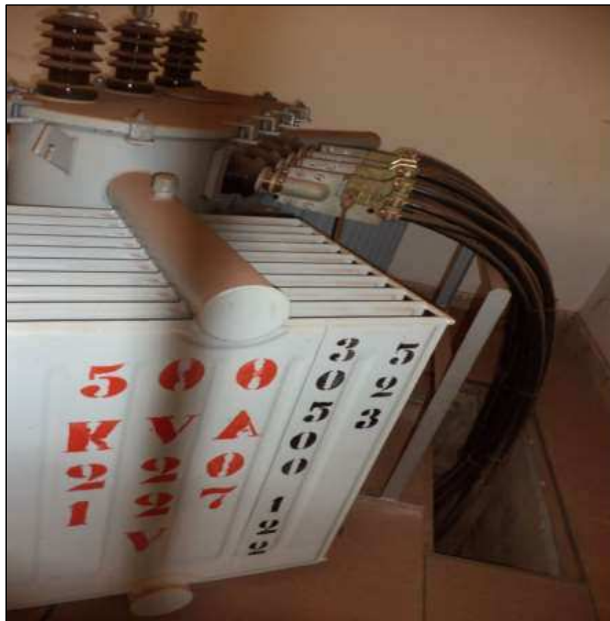
Figura 19. Identificação do transformador.
