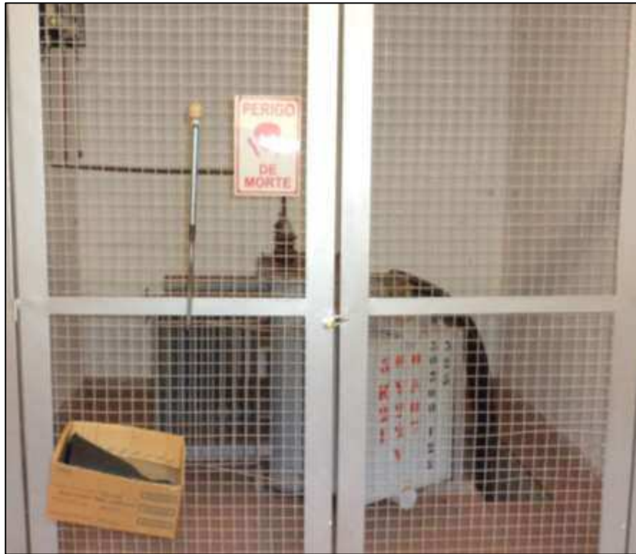
Figura 21. Transformador a óleo 500kVA.
