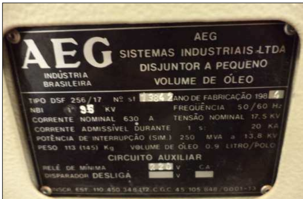
Figura 20. Placa do disjuntor.
