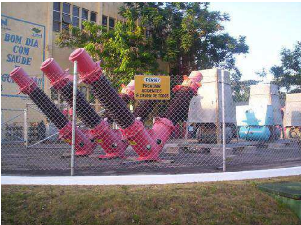
Figura 4. Subestação ao tempo perto de edifício
