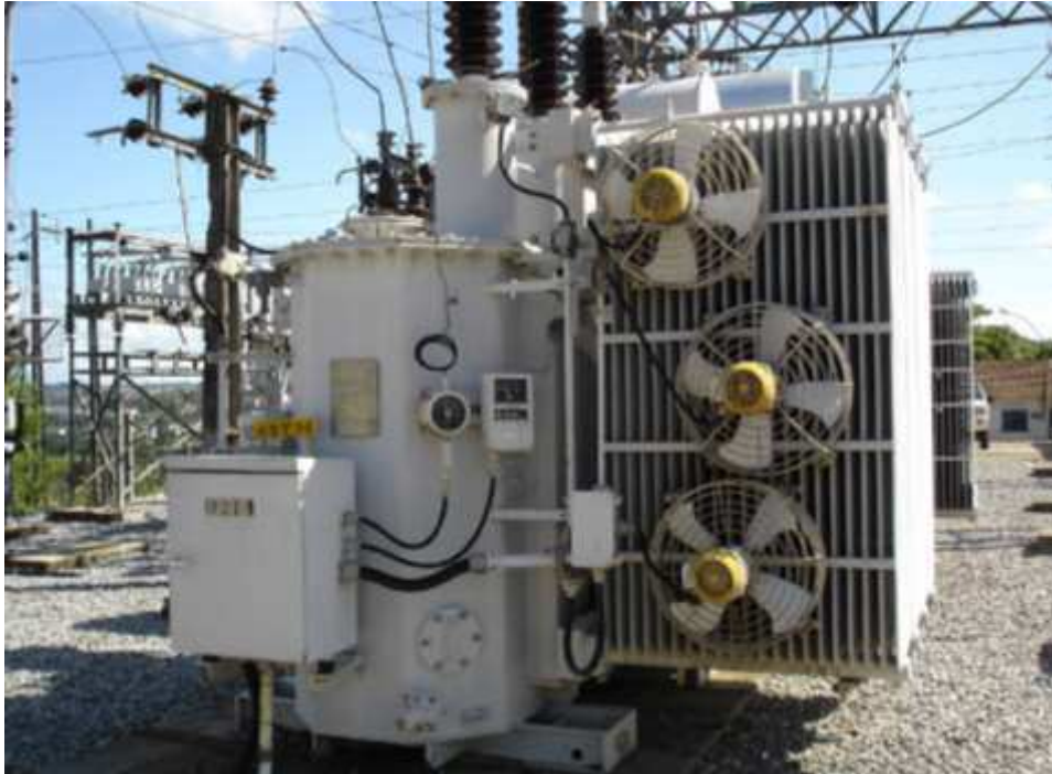
Figura 3. Subestação ao tempo
