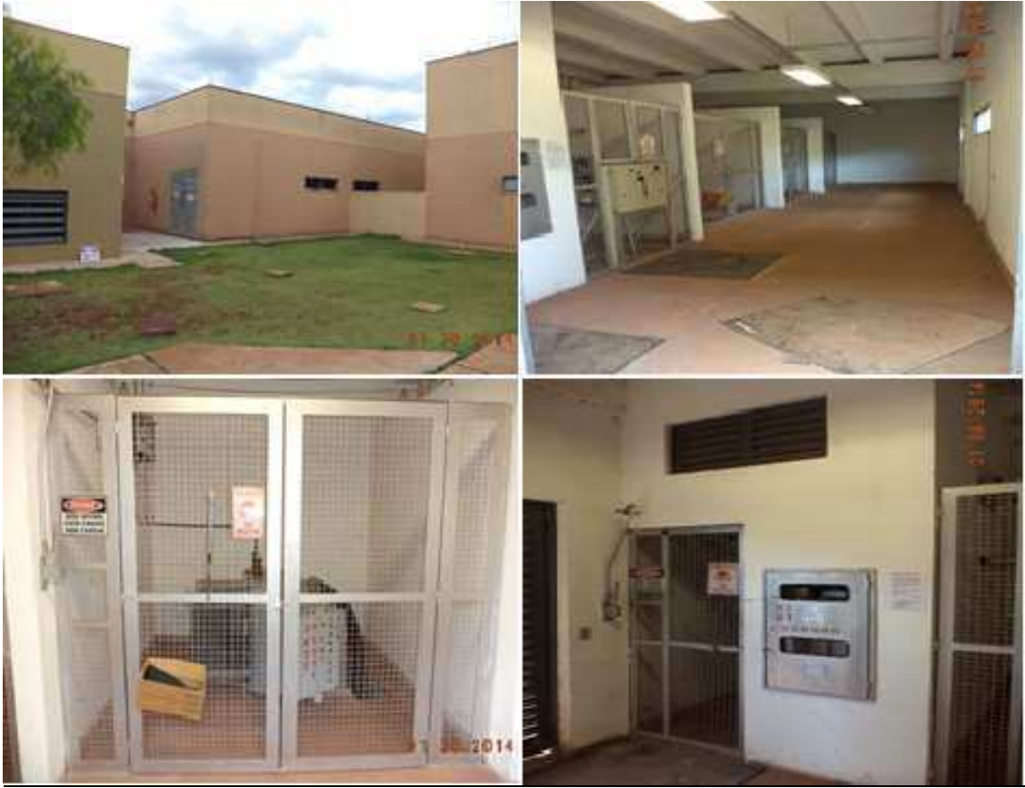
Figura 13. Subestação do HUGD.
