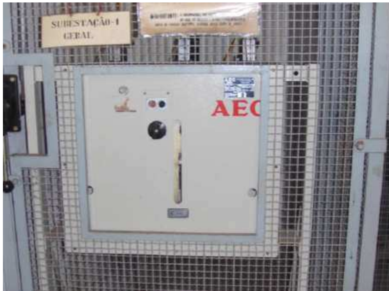
Figura 8. Disjuntor de média tensão.
