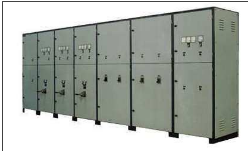
Figura 11. Painel de baixa tensão
