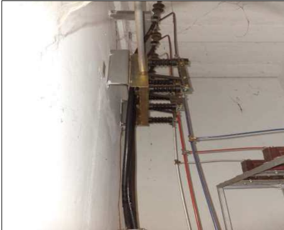
Figura 17. Lado interno do cubículo de medição dentro da subestação da HUGD - Parte 1.
