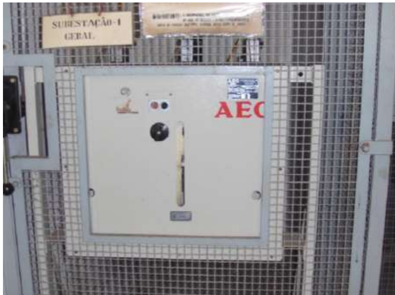
Figura 8. Disjuntor de média tensão.
