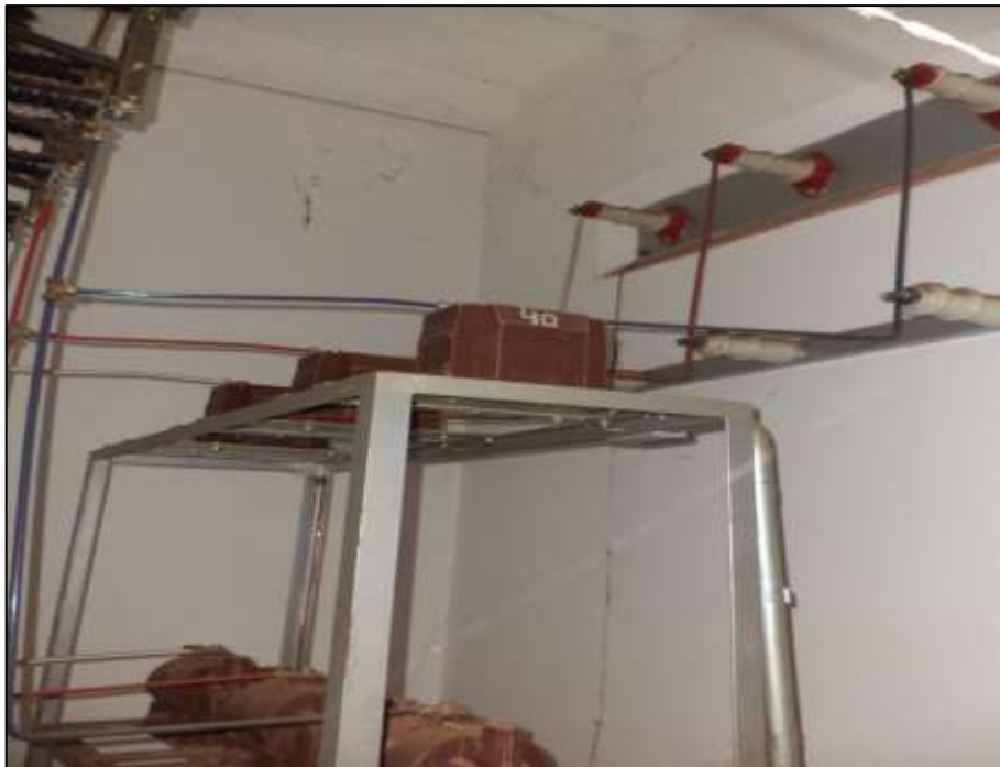
Figura 18. Lado interno do cubículo de medição dentro da subestação do HUGD - Parte 2.
