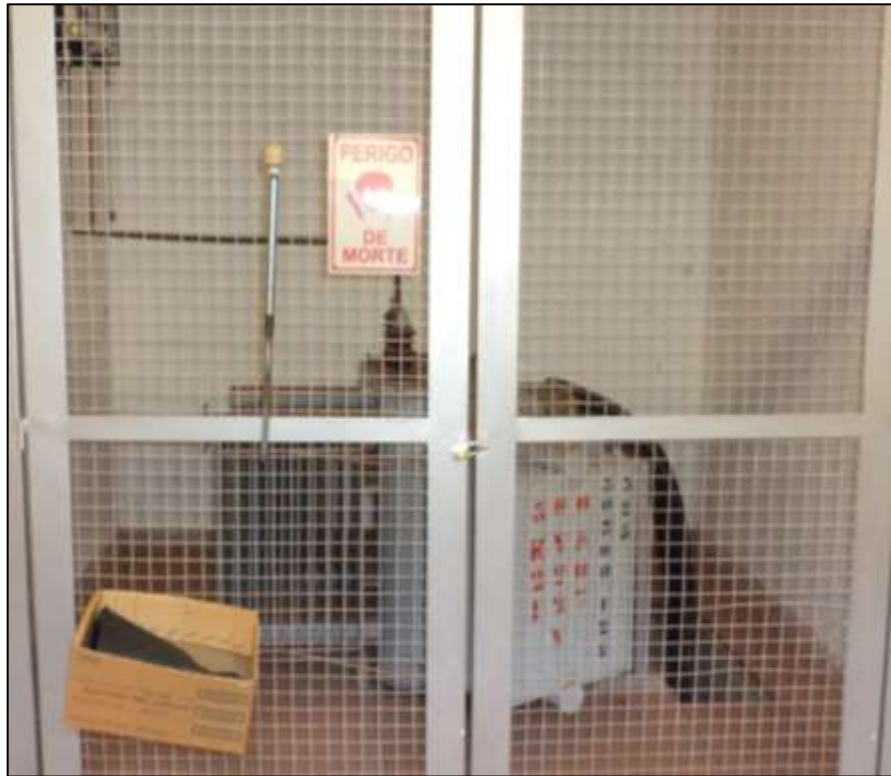
Figura 21. Transformador a óleo 500kVA.
