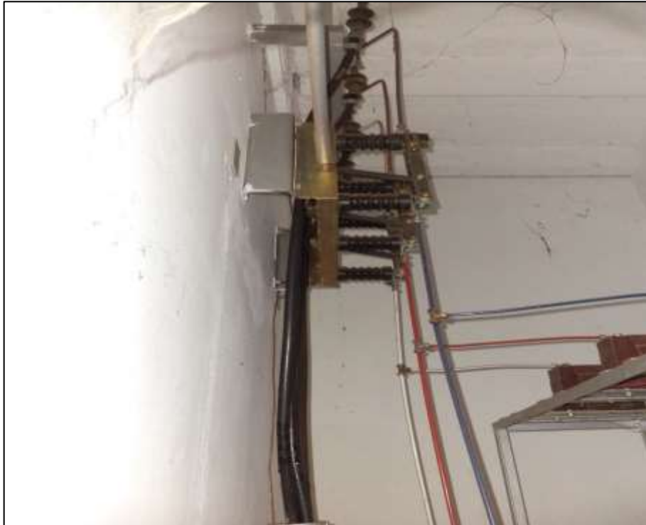
Figura 17. Lado interno do cubículo de medição dentro da subestação da HUGD - Parte 1.
