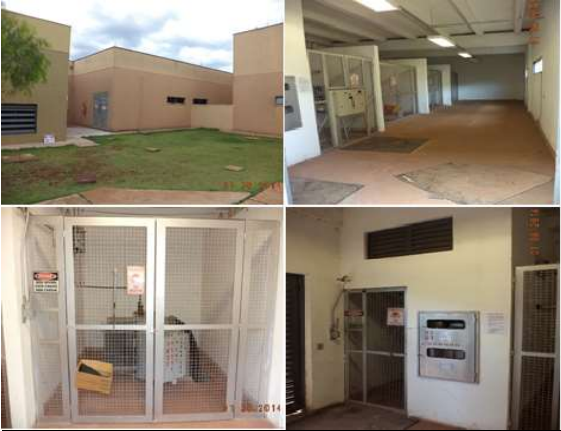
Figura 13. Subestação do HUGD.
