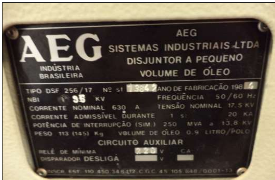
Figura 20. Placa do disjuntor.
