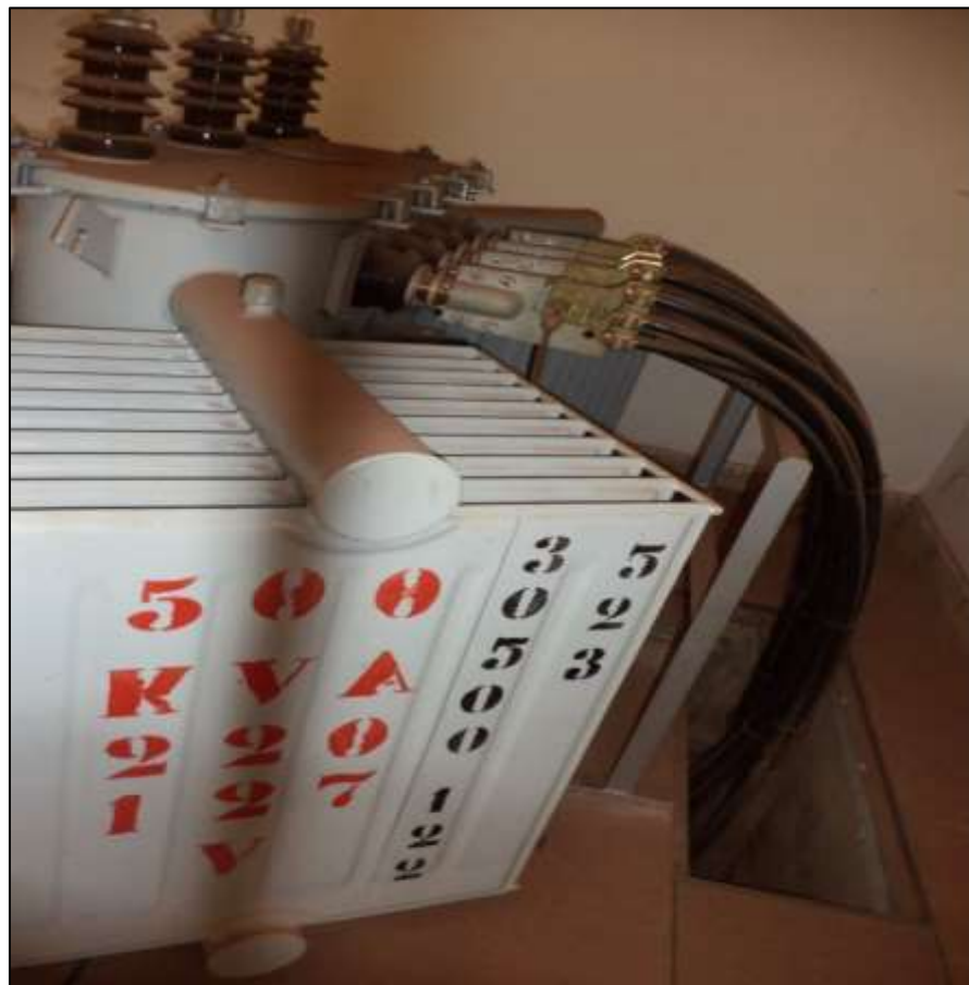
Figura 19. Identificação do transformador.
