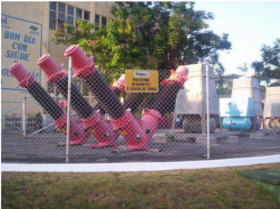
Figura 4. Subestação ao tempo perto de edifício
