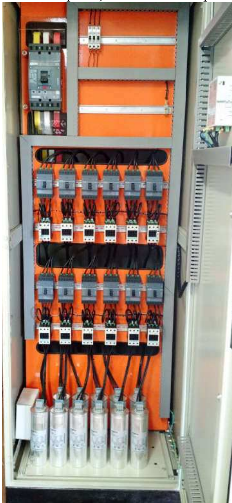
Figura 17 – Novo quadro de comando elétrico, onde se encontram os equipamentos de acionamento e proteção das células capacitivas.
