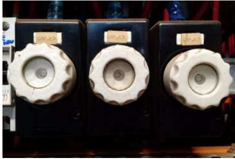
Figura 15 – Equipamentos de proteção do circuito das células capacitivas.
