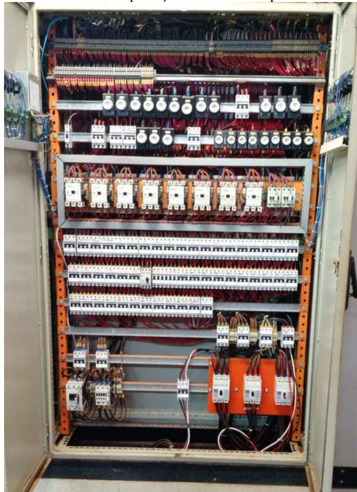
Figura 16 – Quadro de comando elétrico, onde se encontram os equipamentos de acionamento e proteção das células capacitivas.
