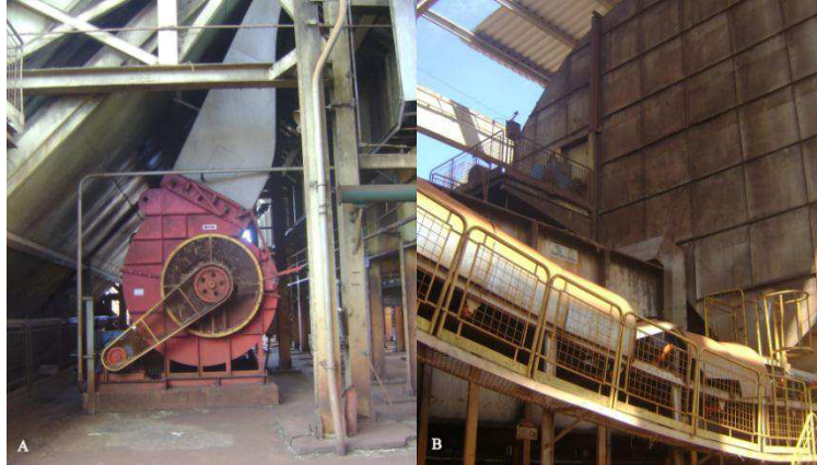
Figura 37. A) Soprador do sistema de lavagem a seco da cana de açúcar. B) Lavador a seco da cana de açúcar.
