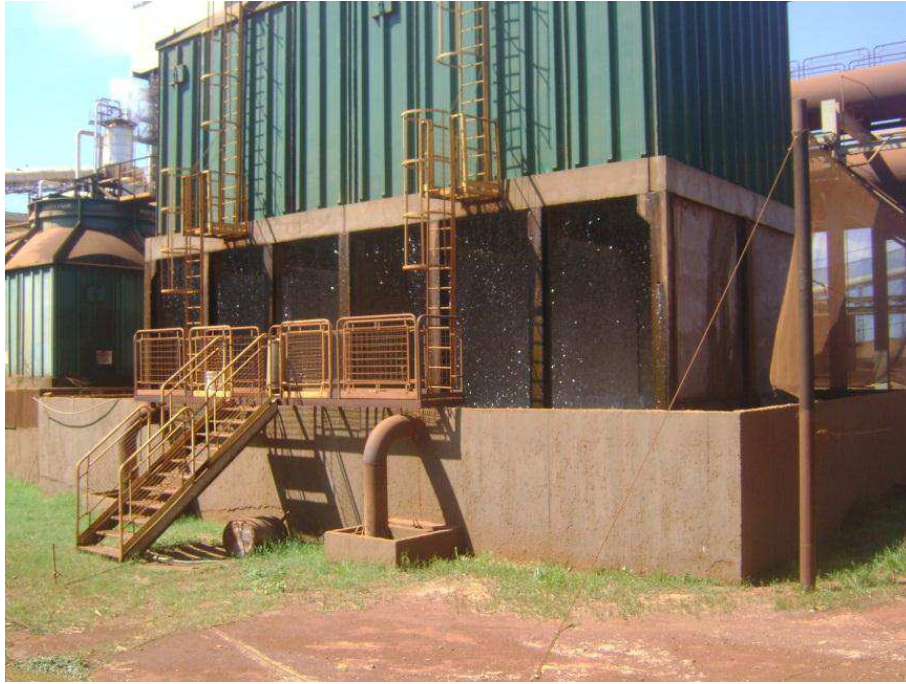
Figura 38. Torre de resfriamento de água da cogeração de energia. Fonte: Autor.
