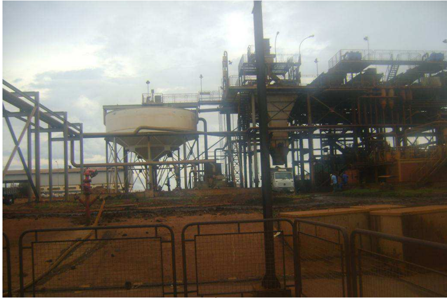
Figura 9. Estação de Tratamento de Água de Lavagem de Gases e filtro prensa. Fonte: Autor.
