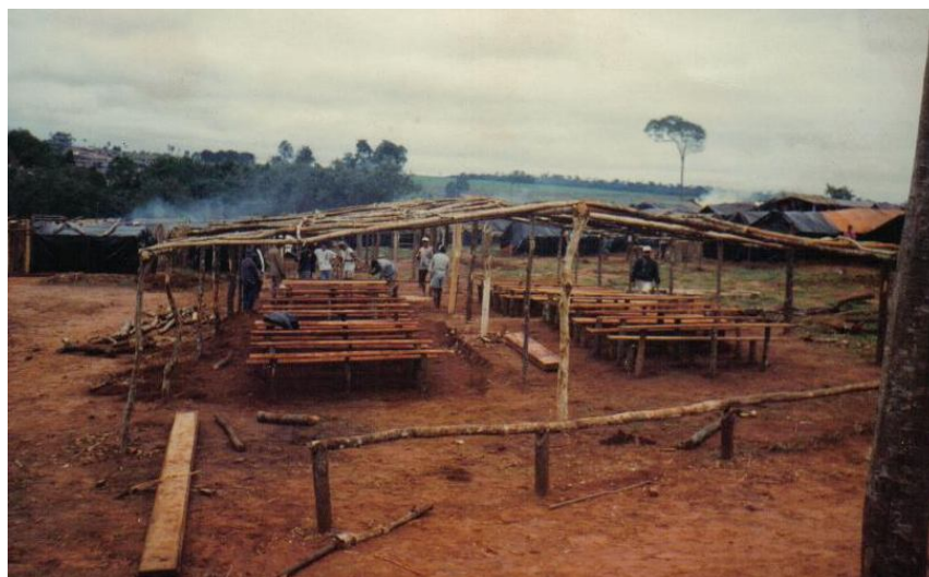
Figura 13: Construção da escola no acampamento Oito de Março. Foto cedida por Claudinéia.
